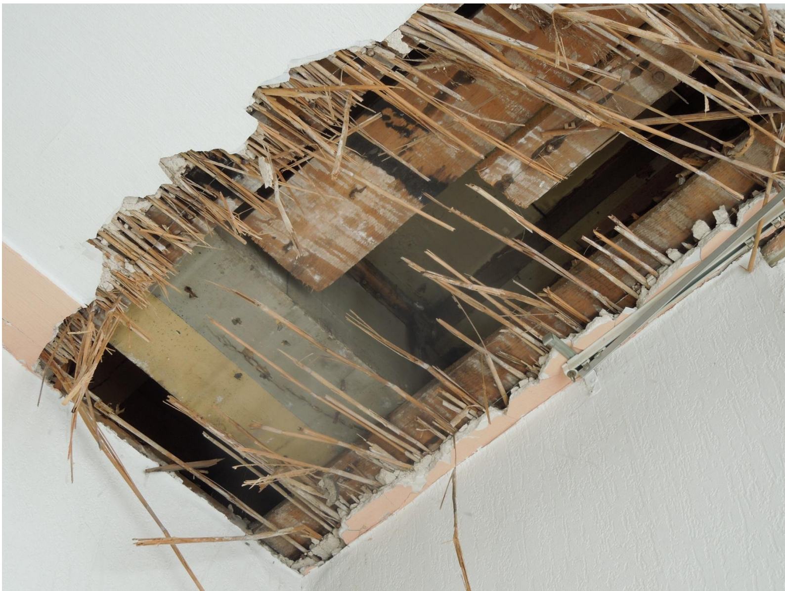
16 – in ruimte P02.03 is een gat gemaakt in het stucplafond, waarbij een samengestelde balklaag in het zicht is gekomen. De moerbalk is in twee kleuren geschilderd, wat mogelijk verband houdt met een andere ruimte-indeling van het 17 de eeuwse poortgebouw.
