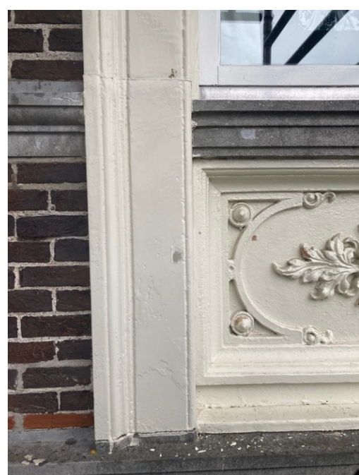
Onderkant raampartij op verdiepingsniveau Onderbroken vensterbank / waterlijst Onderste deel van raamomlijsting van natuursteen met daartussen borstwering met ornamenten Bovenste deel van omlijsting (raamkozijn) van hout
