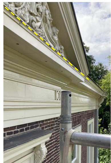
Daklijst met centrale timpaan Het hout van de timpaan is oud, dat van de daklijst is vernieuwd
