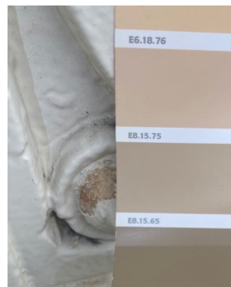
Derde afwerking: licht bruinroze E8.15.65
