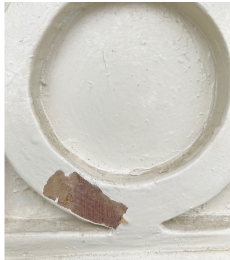
Puncties laten hier ook zien dat onder de huidige verflaag, geen historische kleurlagen aanwezig zijn.
