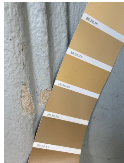
Op de rondboog en overige onderdelen is dezelfde kleur laag aanwezig
