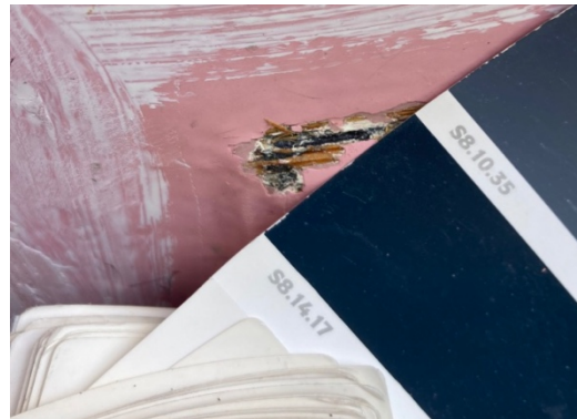
Kleurmatching is hier heel moeilijk vanwege de weinige kleursporen; maar de oude donkere verflaag lijkt een blauwe zweem te hebben, zoals de eerste donkere laag op de tuindeuren
