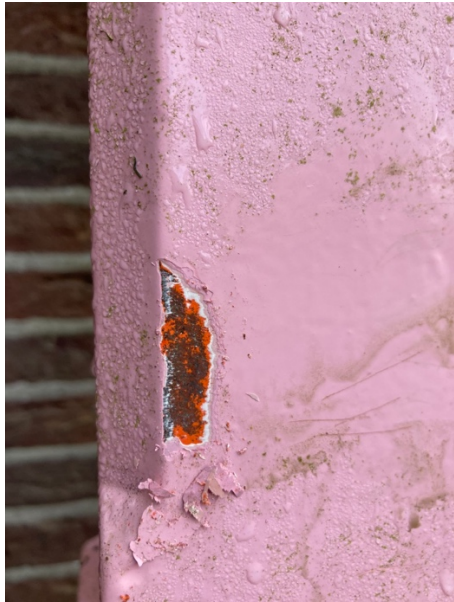
Punctie op ijzeren deel van linker veranda
