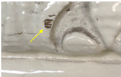
Detail van middenstijl; punctie toont kaal hout
