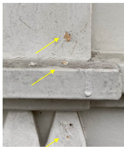
Puncties op de daklijst aan de westgevel laten ook onder de recente roomwitte verflaag, enkel kaal hout zien.
