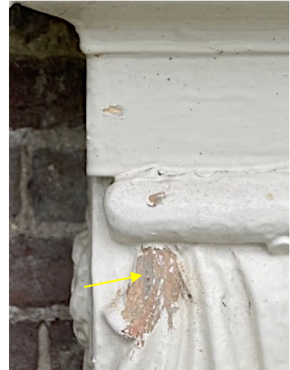
Vaag zichtbaar is een oude grijze verflaag
