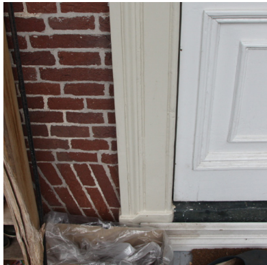
In het rechter geveldeel is de deur in de strek van het keldervenster aangebracht. De deuropening is dus jonger.
