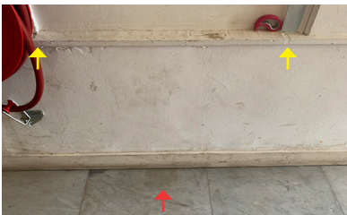
Spoor van het muurtafeltje in de gang. Uit de naden blijkt dat de tafel is afgezaagd (gele pijl). Op de marmeren tegel is een afdruk van de sokkel te zien.
