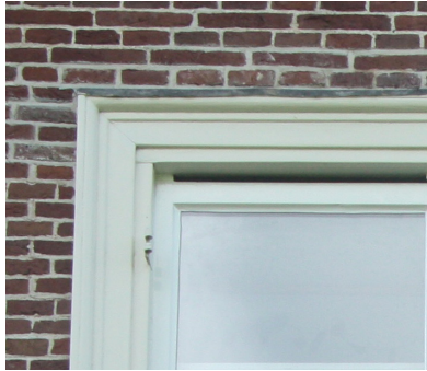
Vensteropening zonder strek, recht kozijn, kozijnlijst met kwartrond profiel. (1991) Raam is vernieuwd. (1991)
