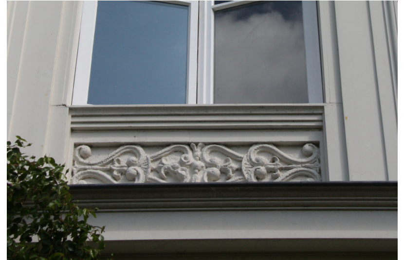
Borstwering boven de middelste tuindeuren.
