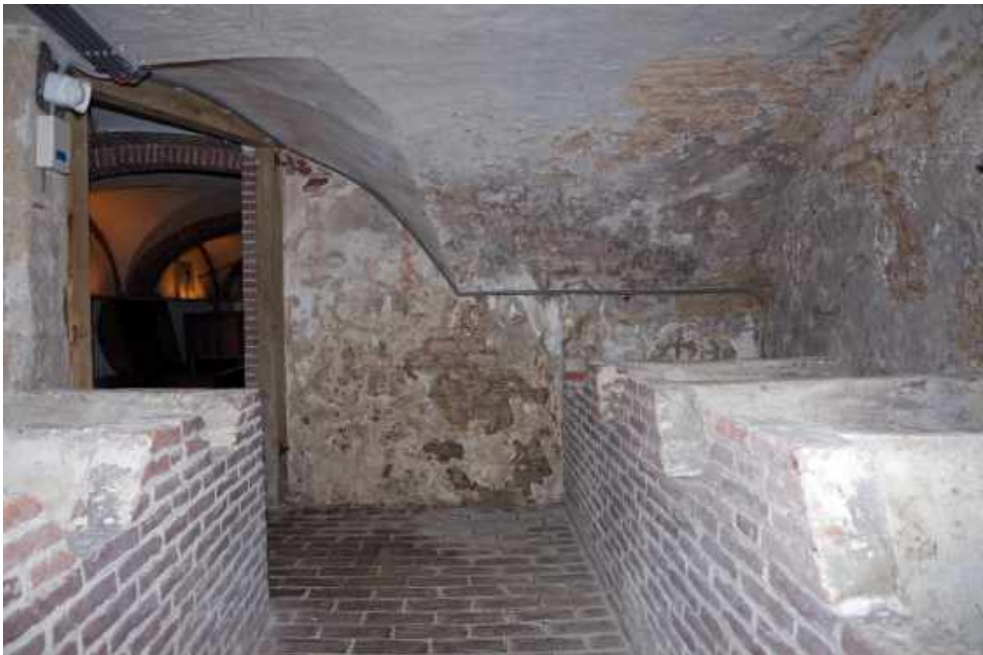
152 Kelder (-1.1), overdekt met gedrukt tongewelf; aan weerszijden gemetselde bakken voor bier- of wijnvaten.
