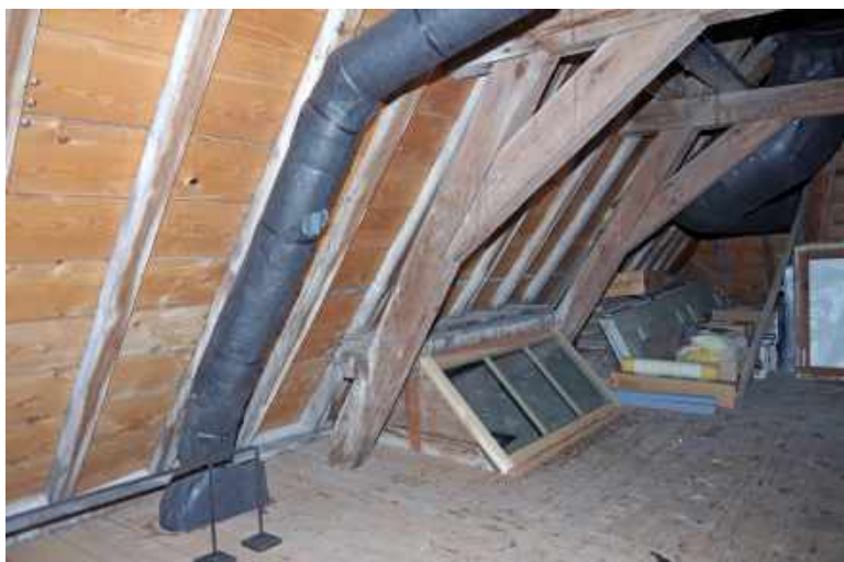
351 Koekoek met legraam ter plaatse van de westelijke dakkapel aan de zuidzijde (meidenkamer 2.13).
