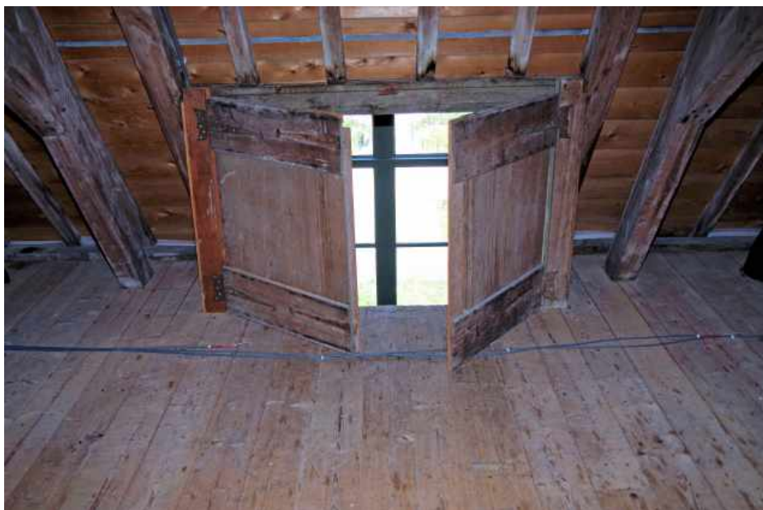
354 Turfluk ter plaatse van de middelste dakkapel aan de noordzijde.
