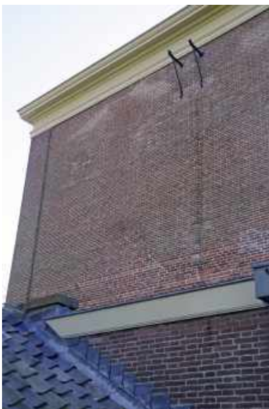
148 Westgevel; ter plaatse van de liseen is er geen verkropping in de gootlijst.
