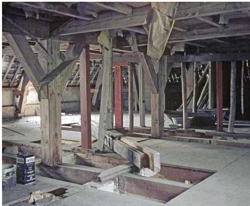
111 De kapconstructie op de zolder rond 1965 met sporen van waterschade en badkuipen onder de zakgoot vanwege de lekkage. (Herkomst: Beeldbank HUA; Foto H. de Wijs)
