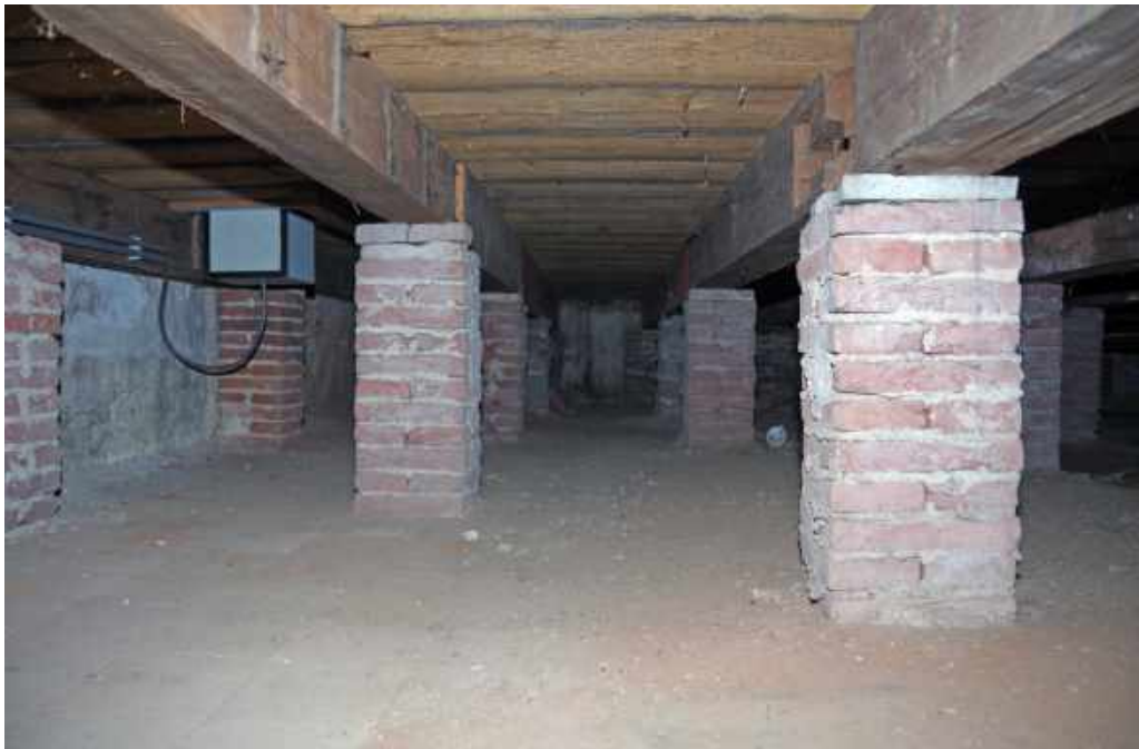
38 Kruipruimte onder ruimte 0.9 (Vogeltjeskamer) met een tegelvloer van het huis uit circa 1730 met daarop bakstenen poeren. Aan de sparingen in de rechter vloerbalk is te zien dat het om een hergebruikte balk gaat.
