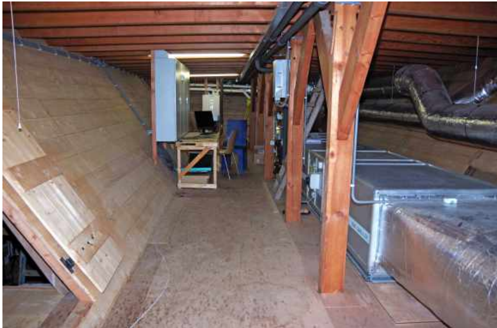
361 Overdekte zakgoot met standvinken als ondersteuning van het platte dak.
