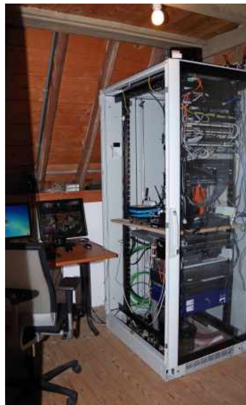
338 Overloop (2.8) met installatieruimte, ingebouwd in 'bedstede' ruimte in zuidoosthoek (2.8B).
