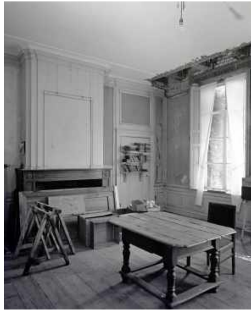
106 Ruimte 1.9 op de verdieping in 1973 met in de hoek de schade aan het plafond. (Herkomst: Beeldbank HUA)
