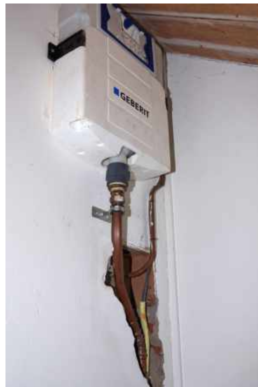
245 Moderne stortbak, geïnstalleerd in trapportaal naar de kelder.
