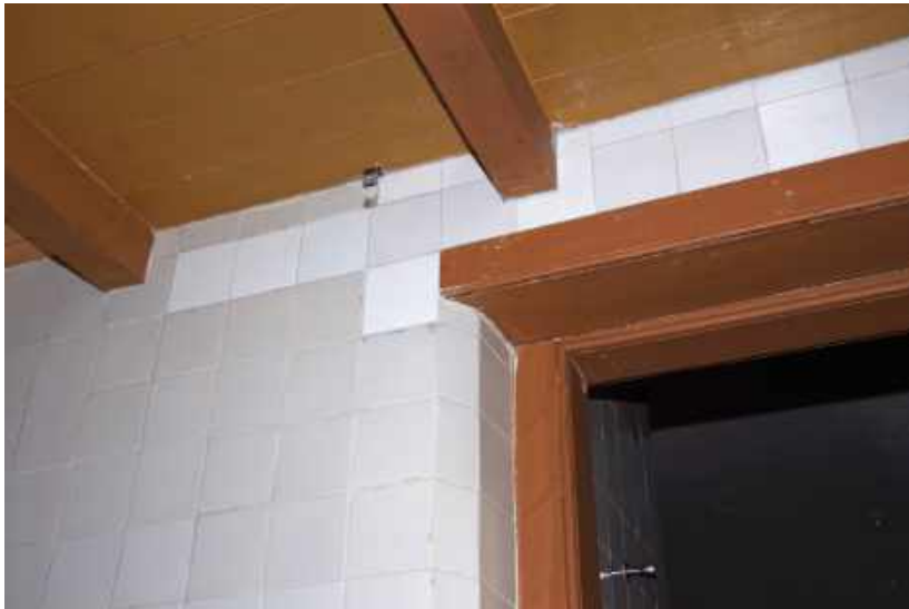
255 Uiteinde balkanker van de keukenschouw onder tegen de balkenzolde-ring in de bijkeuken.
