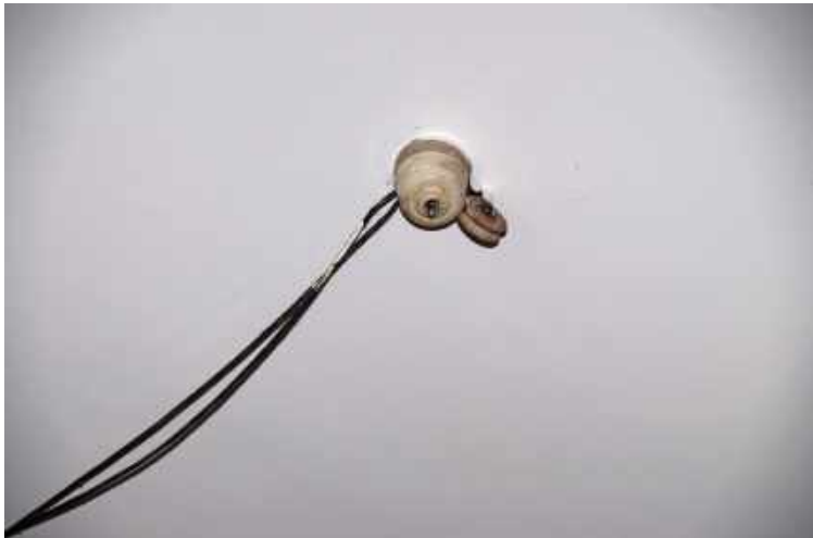
233 Porseleinen schakelaar en bedrading uit de tijd van de aanleg van elektrisch licht.
