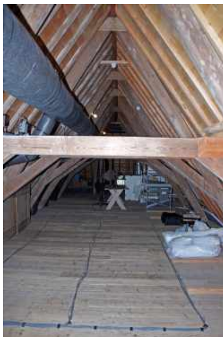
352 Noordelijk deel van de vliering, gezien in oostelijke richting. Deels nieuw dakbeschot ter plaatse van overdekte zakgoot.
