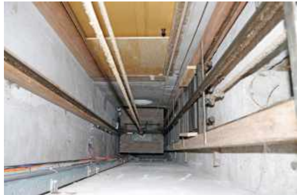
96 Liftschacht, gezien naar de bovenzijde van de liftkooi, gevat in geleidestangen en rechts het contragewicht met touw.
