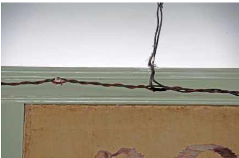
104 Detail van een met katoen omwonden elektriciteitsdraad en porseleinen afstandhouder in de Fazantenkamer.
