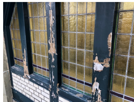
Oude vullingen in het houtwerk
