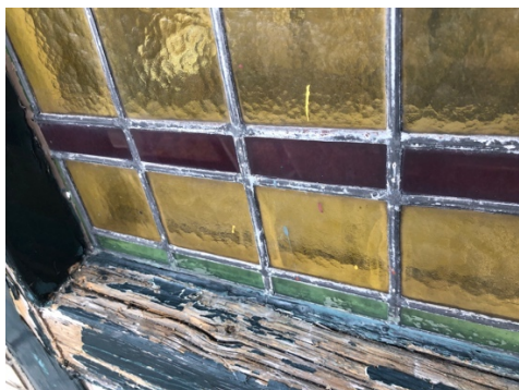
Beschadigingen van het kozijn
